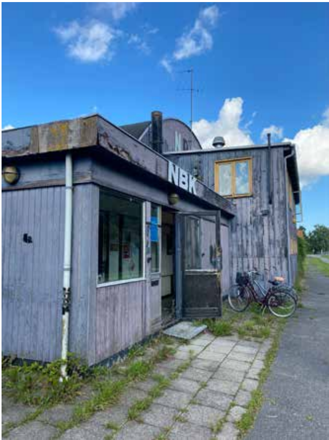
Indgangsparti til klubben - i meget dårlig forfatning
